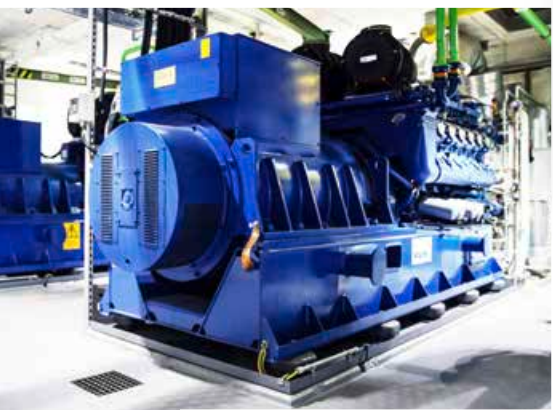
Heizkraftwerk: Insgesamt fünf solcher Aggregate erzeugen Wärme und Strom für Meiningen.
