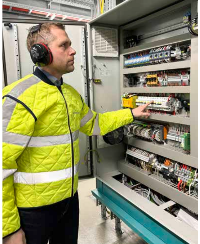
Betriebsleiter Strom/Wärme/Leittechnik Andreas Berger am Schaltschrank von „Sabine“. Die Lautstärke im Raum gleicht in etwa der beim Start eines Düsenjets.
